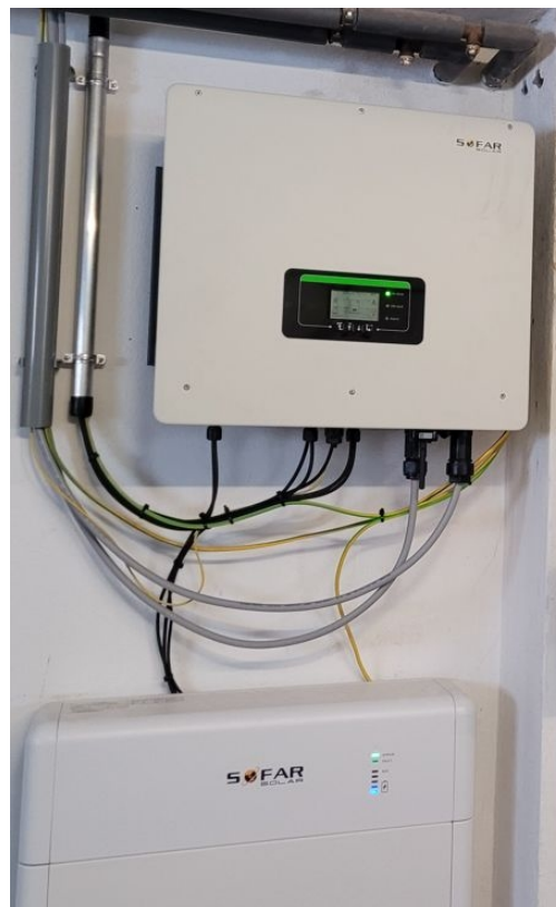
Speicher und Lademanagement.jpg
