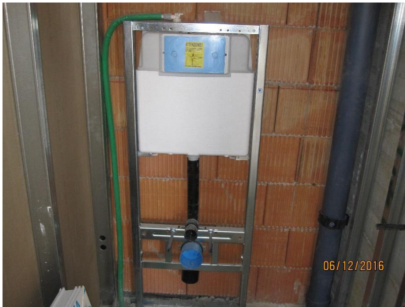
Top 6 – Foto Bauphase – keine luftdichte Ebene (Putz) hinter der Installation vorhanden
